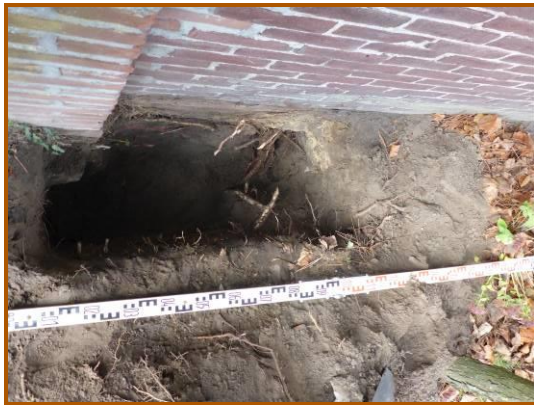
Afbeelding 6: Inzichtelijk maken van wortels onder de fundering
