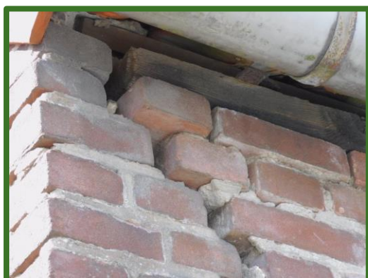
Gaten in de muur
