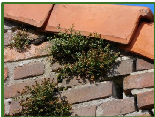
Muurvaren tussen de stenen aan de zuidelijke kopgevel
