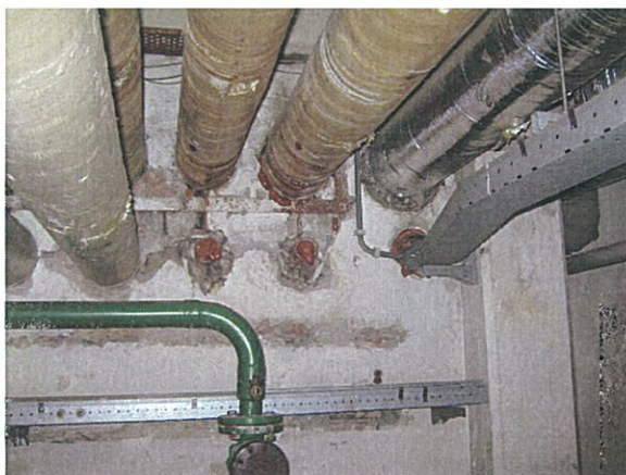
algemene foto van leidingwerk in ketelhuis
