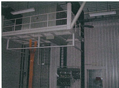
Foto F04: Binnenmuren opstallen, op diverse plaatsen elektrische schakel-, verdeel-, zekeringen-/stoppenkasten: niet toegankelijk
