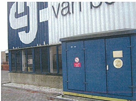
Foto F02: Gebouw 29, hoogspanningsruimte: niet toegankelijk
