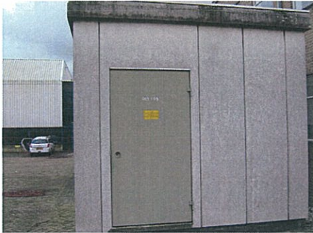
Foto F01: Gebouw 80, hoogspanningsruimte: niet toegankelijk
