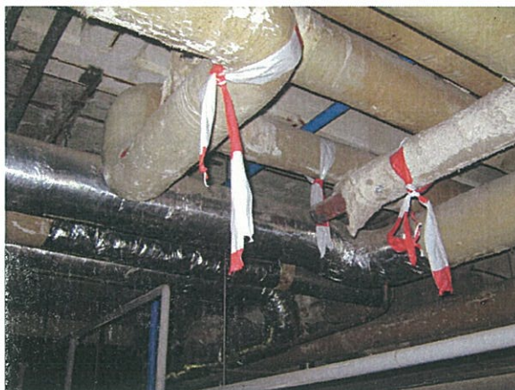
algemene foto van leidingwerk in ketelhuis
