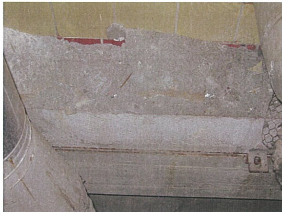
willekeurige foto van "asbestverdacht" stof in ketelhuis
