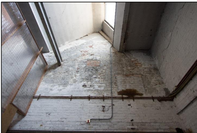
Afbeelding 3.24 Op enkele plekken is nog bouwsubstantie aanwezig die vermoedelijk teruggaat tot de late negentiende eeuw. De mate waarin deze substantie is aangetast is hoog. Op de foto een aangepaste daklijn, dichtgezette gevelopening en een secundaire perforatie die weer is dichtgezet, te zien (foto: A. Oldenmenger).
