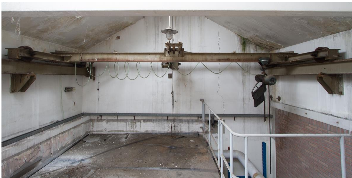
Afbeelding: Loopkraan in gebouw XIII, mogelijk uit de bouwtijd.
