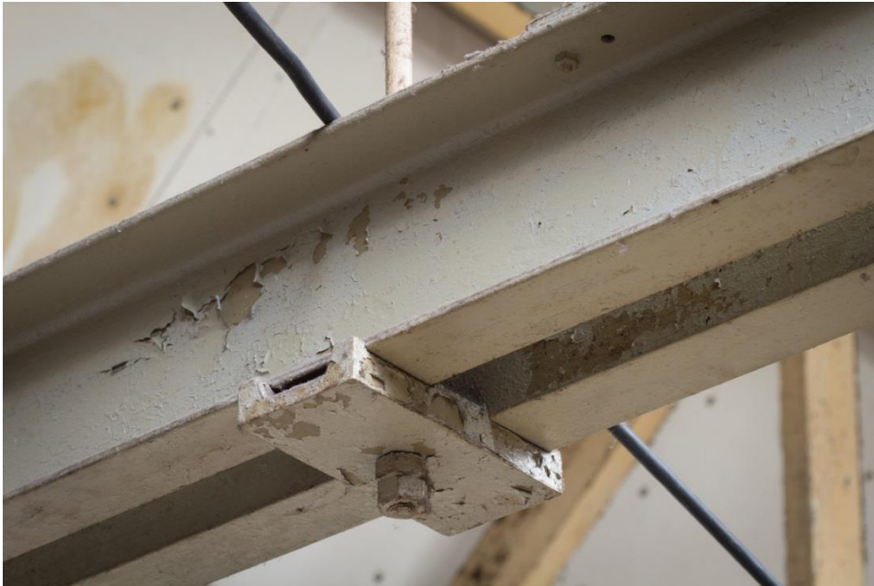
Afbeelding: Detail van de wijze waarop de trekstang is bevestigd aan de profielbalken uit 1907.
