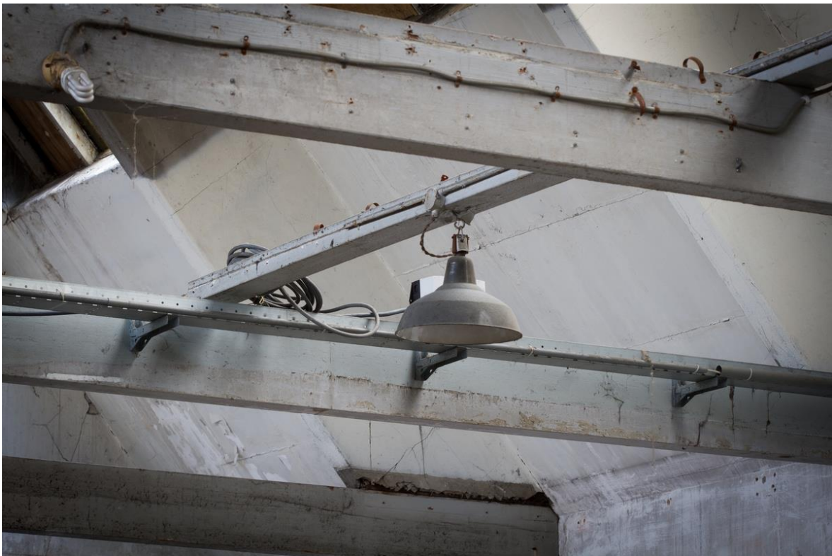
Afbeelding: In de voormalige spoelerij zijn nog enkele fabrieksarmaturen voor verlichting aanwezig.
