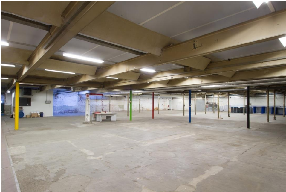
Afbeelding: Een deel van het gebouw is voorzien van een nieuwe draagconstructie uitgevoerd in staal. Vermoedelijk is dit gedaan vanwege belemmeringen van de relatief kleine afstand tussen de gietijzeren kolommen.
