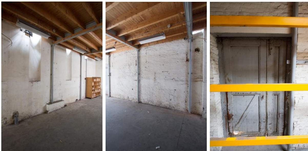
Afbeeldingen: Links een muur met uitsparingen in de muur die dit gebouw scheidt van de machinekamer. De stalen spanten en zoldervloer is een toevoeging. Midden, moeilijk te zien, dichtzettingen in de muur, in dit geval een muurdeel dat oorspronkelijk de weverij (gebouw VI) toevoerde. Rechts een mogelijk nog laat negentiende-eeuwse deur van de voormalige weverij (gebouw VI).
