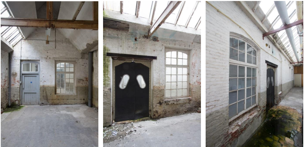
Afbeeldingen: Links de voormalige voorgevel van binnenuit gezien. Gevelopeningen zijn hier onder een latei uitgespaard. In het midden een opname van de linker zijgevel van binnenuit, rechts dezelfde situatie maar dan gemaakt waar het tot 1907 buiten was. Vensters is oorspronkelijk, de deur uiteraard toegevoegd.
