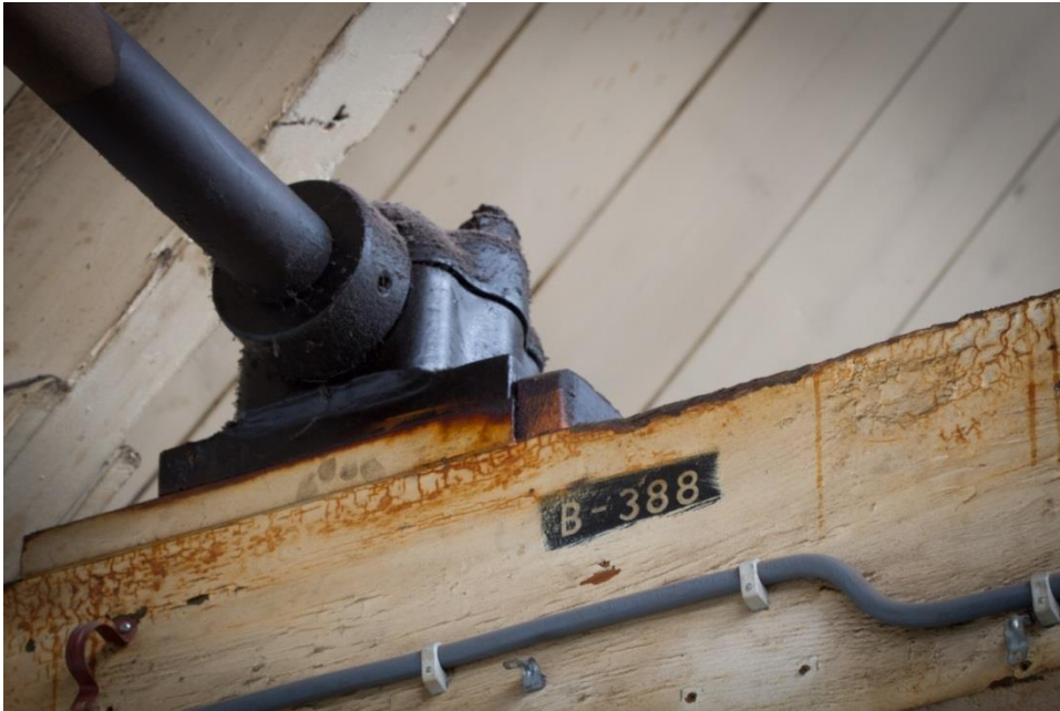
Afbeelding: Lager ten behoeve van een aandrijfas, aangebracht op een balk van een kapsant.
