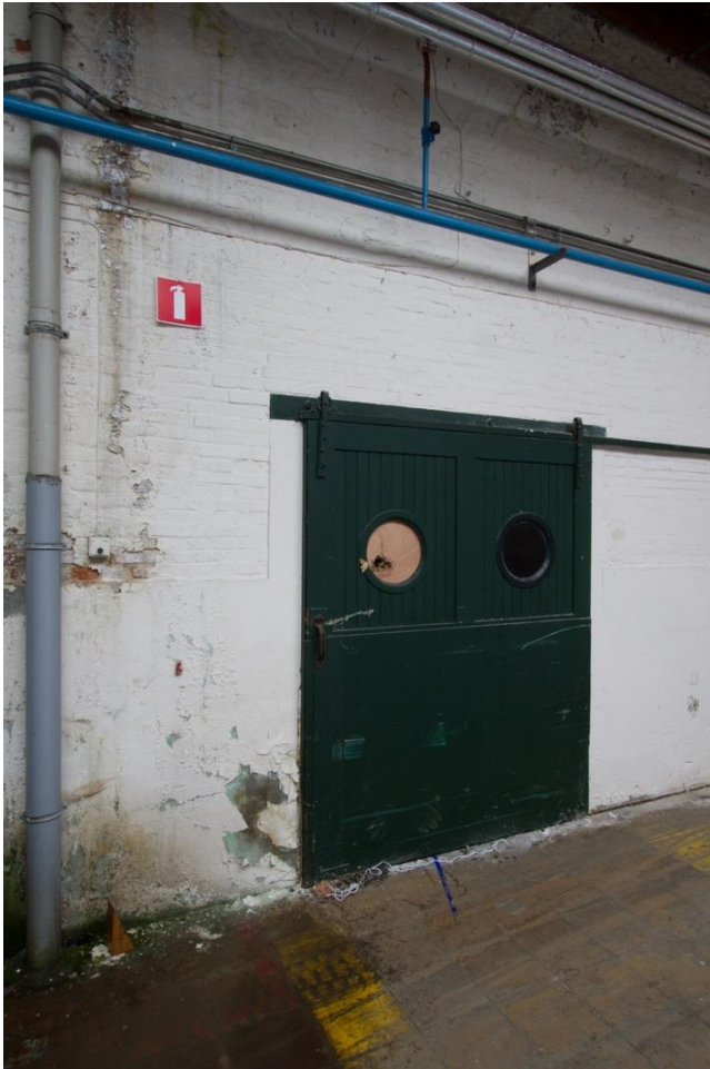
Afbeelding: Op de foto vrijwel niet te onderscheiden, een oudere daklijn (midden boven de jaren vijftig deur) en een dichtgezette gevelopening onder een segmentboogje (links boven de deur). Deze muur is mogelijk nog laat negentiende-eeuws.
